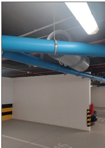
Slika 3. Slaba funkcija ventilatora
